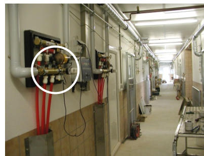
Abb. 15: Richtig - alle Versorgungsvorläufe wurden ausreichend gedämmt
