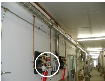
Abb. 14: Falsch - fehlende Dämmung der Versorgungsvorläufe
